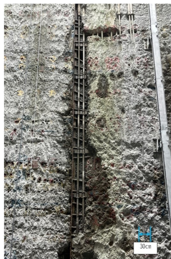
写真は原電が提供した、コンクリートが破損し鉄筋がむき出しの防潮堤の一部
